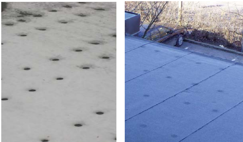
Bild 2.3 Genomföringar skapar köldbryggor på tak. I den vänstra bilden kan vi se hur värmen som strömmar upp genom köldbryggan smälter snön på taket. I den högra bilden har nattfrosten smält bort.
