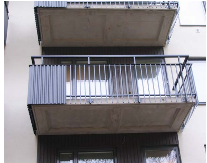
BILD 4.18 Vid balkonger får det finnas brännbar fasadbeklädnad om balkongplattan ansluter tätt mot fasaden samt har obrännbart räcke.
